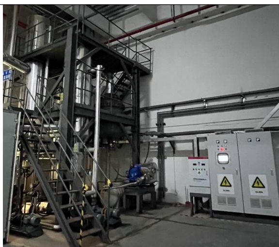
废水处理站浓水蒸发系统
