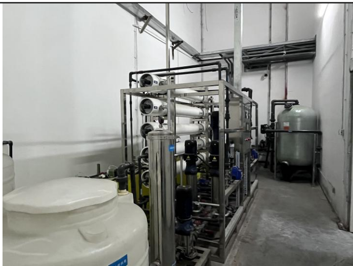
废水处理站中水回用系统
