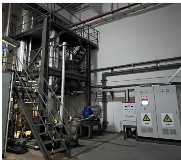
废水处理站浓水蒸发系统
