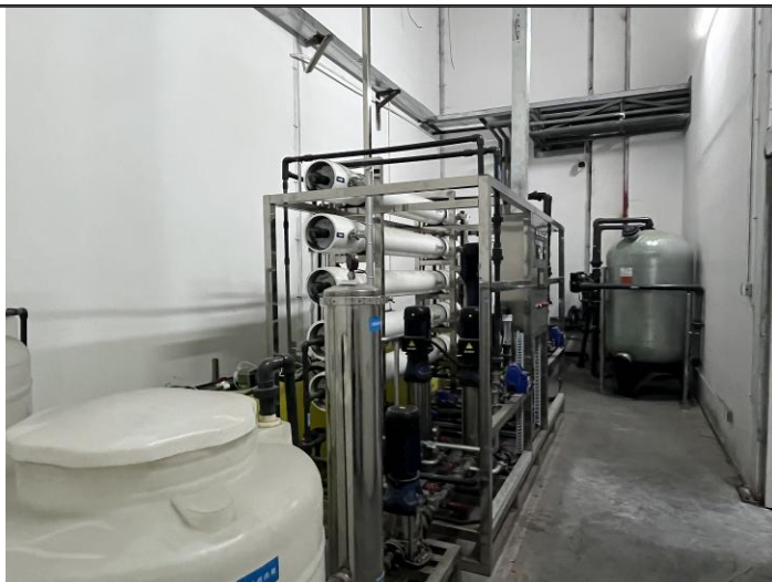
废水处理站中水回用系统
