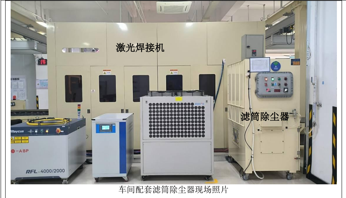
图 11 项目废气污染防治措施现场照片
